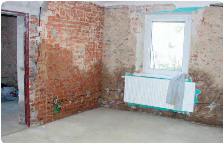
Očištěné, ale vlhké zdivo
