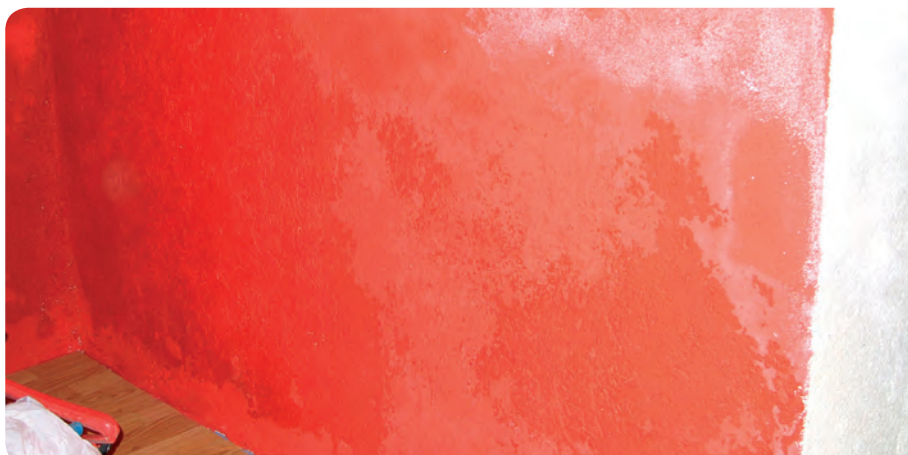
Na omítce špatně vysušeného zdiva se časem objeví mokré fleky (levá část) a vyzvlíná sůl (pravá část) zdroj: Člověk v tísni
