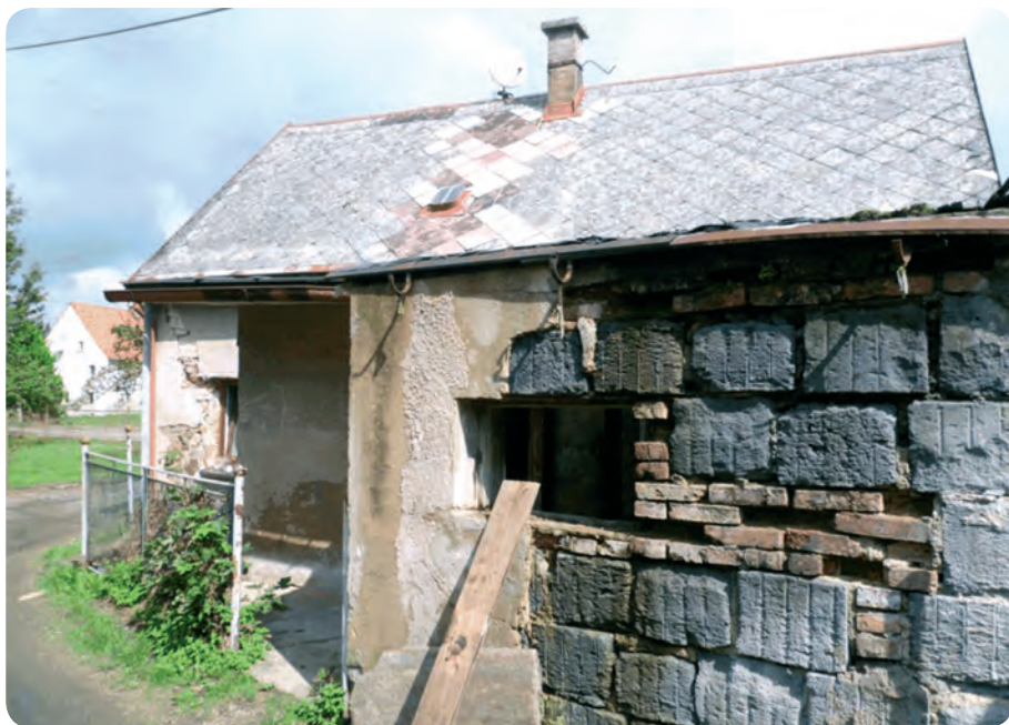
Poruchy způsobené špatnou údržbou objektu
